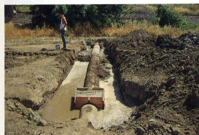
漏水する水管。地中に埋めてある水管にひびが入り漏水しているところ。このような水漏れは工事直後はいたるところで始まっていた。
